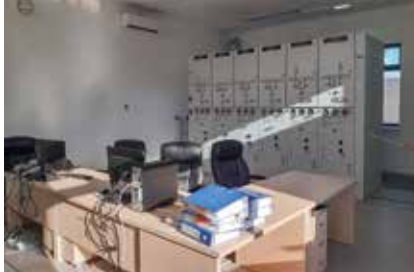
5. kép: Újszász állomás, beltéri tokozott berendezés
