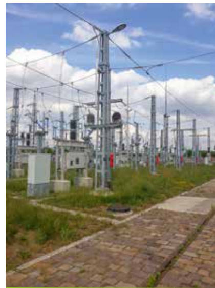
3. kép: Szerencs alállomás, 25 kV-os szabadtér
