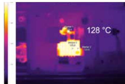
Túlmelegedett UR 6 típusú megszakító hőképe
