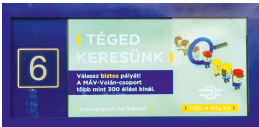
8. kép: HAS-PID-75VV vágányvégi kijelzők induló és digital signage kijelzéssel
