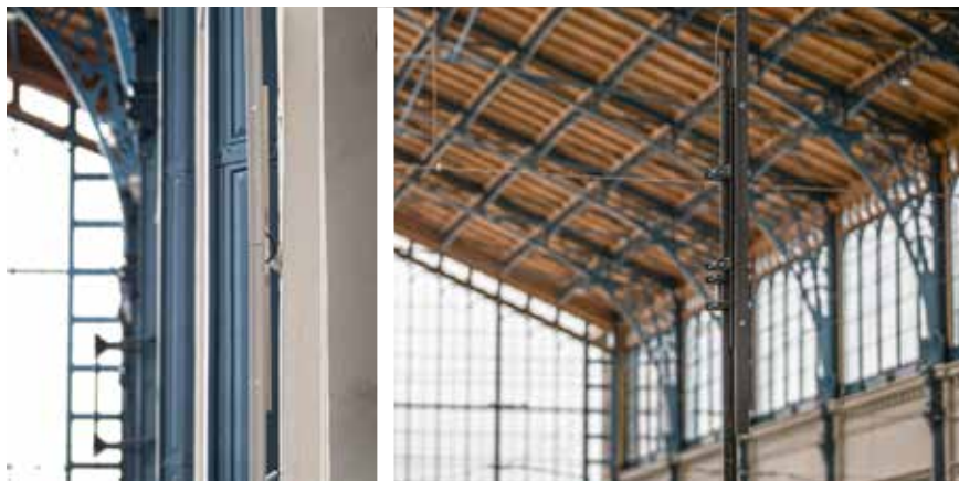
12. kép: Vágánycsarnoki telepített K-Array Kobra KK102 I vonalsugárzók
